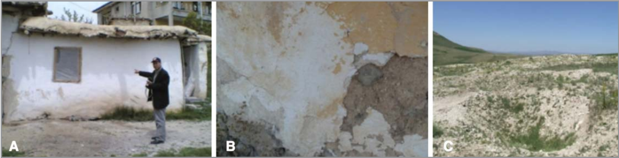
Resim 7. (A) Sivasında altere kireçtaşı malzemesi kullanılmış evlerin duvarları, (B) Kalsit ( \text{CaCO}_3 ) bileşimli sıva malzemesi, (C) Sıvada kullanılan kireçli malzeme (1,19).
